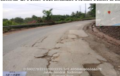
Gambar 4. Deformasi Plastik pada Tikungan Tajam
