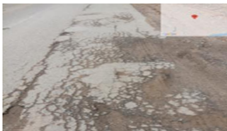
Gambar 1. Jenis Kerusakan Retak Pinggir
