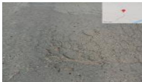
Gambar 2. Jenis Kerusakan Retak Kulit Buaya
