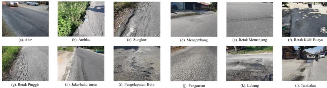
Gambar 3. Jenis-jenis kerusakan yang terdapat pada Jalan Srikandi Sumber: Dokumentasi Penelitian, 2021
